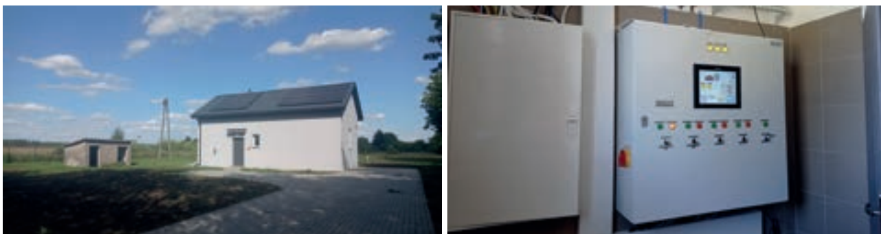
Fot. Stacja Ujęcia Wody w Starym Brusie po modernizacji
